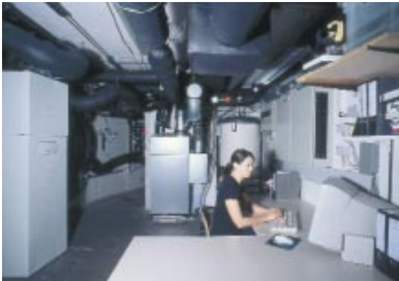
Abb. 1: Automatisierter Teststand mit zwei Testplätzen zur Messung von Lüftungsgeräten mit Abluftwärmepumpe.
