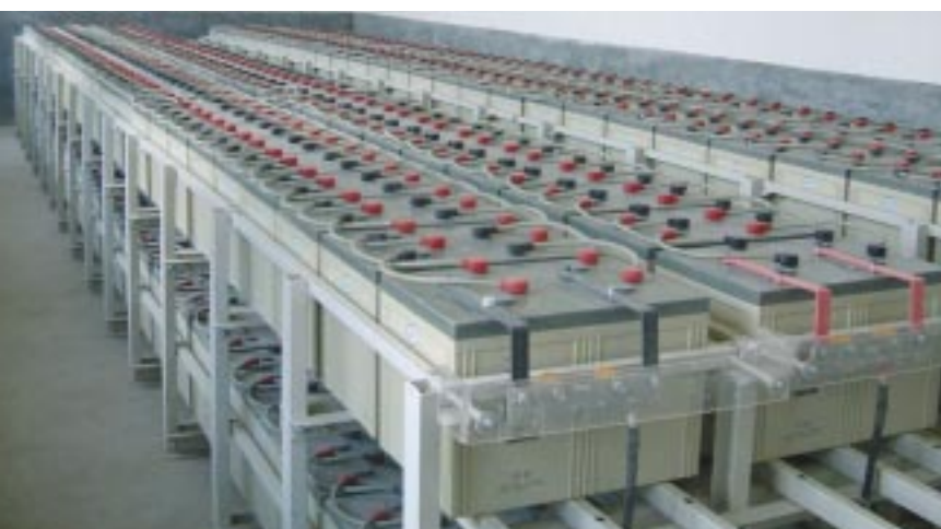
Abb. 2: In fast allen chinesischen Dorfstromversorgungsanlagen werden wie hier im Dorf Dousong ausschließlich Blei-Vlies-Batterien mit einer Systemgleichspannung von 220 Volt betrieben. Da bei dieser Batterieart immer wieder einzelne Zellen unerwartet ausfallen, werden die Anlagen durch Monitoring kontinuierlich überwacht.
