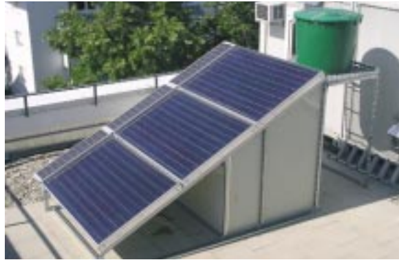
Abb. 3: Erster Versuchsaufbau der vollständig durch Solarenergie autark betriebenen kompakten Meerwasserentsalzungsanlage, wie sie im Oktober 2004 auf dem Dach des Fraunhofer ISE aufgestellt wurde. Die thermische Energie für die Membrandestillation wird durch drei Solarkollektoren bereitgestellt. Die Pumpe und die Steuerungskomponenten werden über ein Photovoltaik-Modul versorgt.
