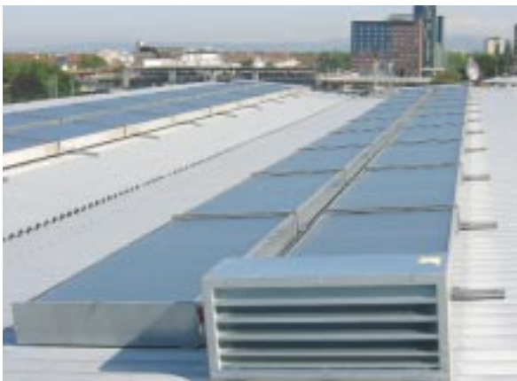
Abb. 2: Klappenkasten (im Vordergrund) zur Abschaltung eines Kollektorstrangs der Luftkollektoranlage auf dem Dach der IHK Südlicher Oberrhein, Freiburg. Durch die Abschaltung einzelner Kollektorstränge wird die thermische Antriebsleistung regelbar, wodurch bei geringen Zuluftvolumenströmen in Teillast ein unnötiger Wärmetransfer in die Raumluft reduziert werden kann.
