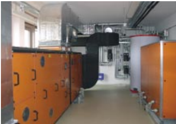
Abb. 1: Technikraum mit Menerga-Anlage. Rechts sind die beiden Solespeicher, im Hintergrund rechts ist der solare Pufferspeicher zu erkennen. Das Lüftungsgerät ist links zu sehen. Die Solarenergie wird im Sommer zur Luftentfeuchtung und im Winter zur Beheizung verwendet.
