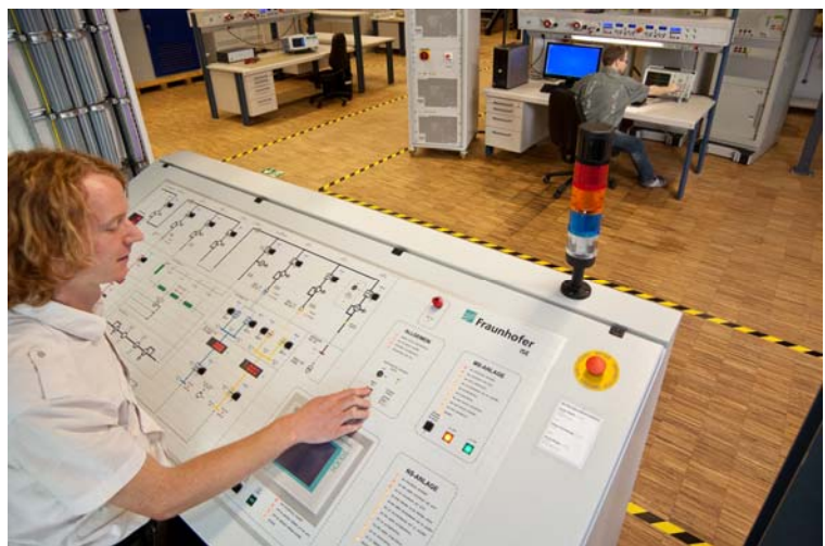
Foto 2: Steuertpult für die »Low Voltage Ride Through«-Prüfeinrichtung zum Test von Wechselrichtern nach der neuen Mittelspannungsrichtlinie. ©Fraunhofer ISE
